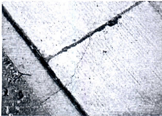
Fotografía N° 15 – 06/03/2015: Fisuras en zarpa de hormigón en calle Francisco Bilbao entre Alejandro Gutiérrez y Alfonso Serrano.
